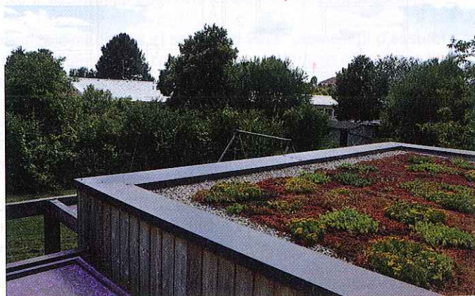
Toits verts. Les toitures sont végétalisées sur une étanchéité en membrane soudée. La végétalisation filtre aussi la pluie ensuite récupérée.
